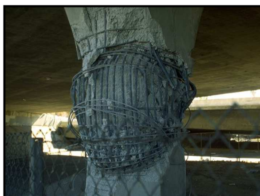
Fig.2.4 Mission Boulevard - Gothic Avenue Bridge. Northridge, 17 Gennaio 1994.
